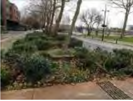
Şekil 10. İTÜ Ayazağa kampüsü yağmur bahçesi uygulamaları (Rakipoğlu, 2024).
